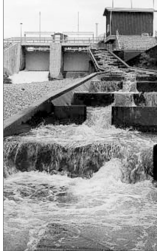
Fisktrappa vid Hednäs kraftverk i Åbyälven, en vildlaxälv.
